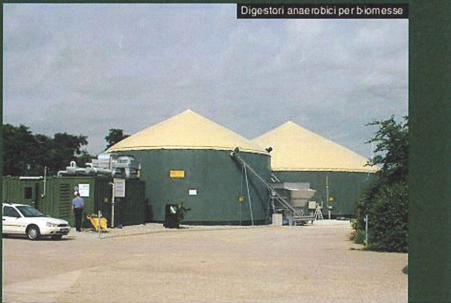
Digestori anaerobici per biomasse
